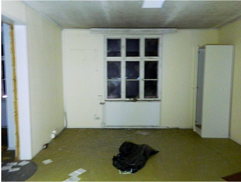
Kuva yllä 52: Näkymä terveydenhoitajan huoneeseen, joka oli alun perin makuuhuone. Yläkerran kattopintoihin on kertynyt mustaa pintahometta huonon ilmanvaihdon ja tyhjilläänolon seurauksena.
