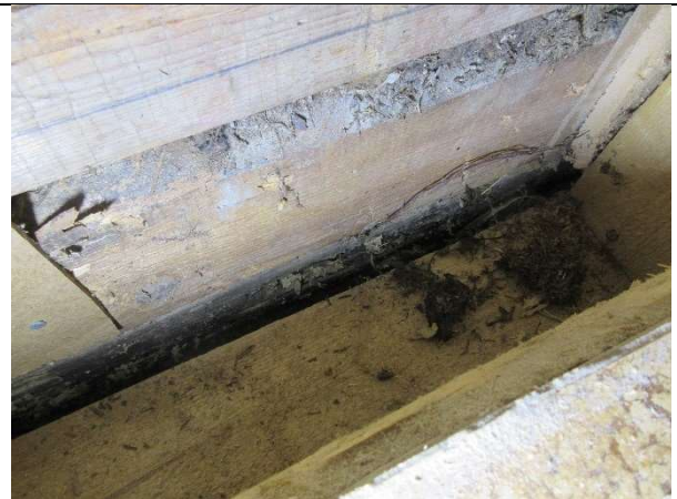
Kuva 3.37. Hirsipinta näkyvissä, koolatun rungon taustalla hirsipinnassa lahovaurioita pinnassa
