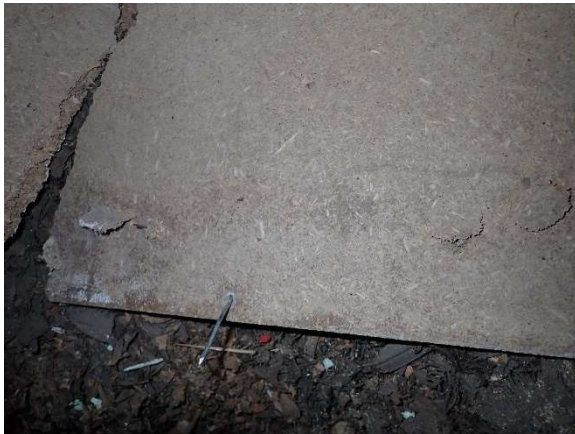
Kuva 3.27. Lastulevyn taustassa aistinvaraisesti vähäisiä kosteusjälkiä
