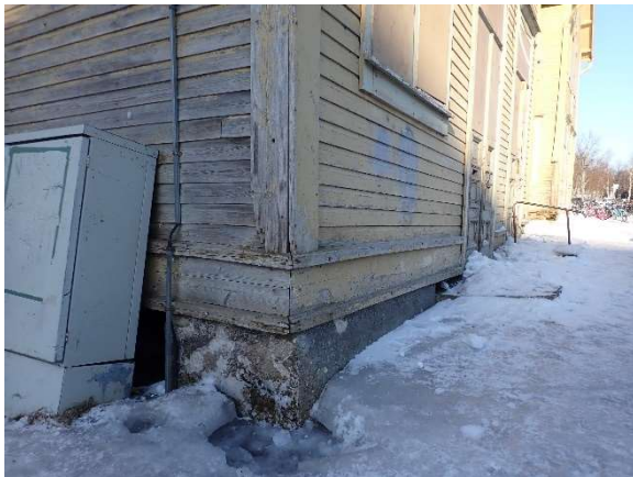
Kuva 3.5. Pohjoispuolen sivu, kuistit painuneet
