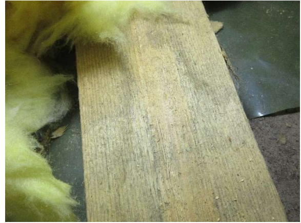
Kuva 3.73. Pohjalla olevan laudan pinta aistinvaraisesti havaittavissa mikrobivaurioita
