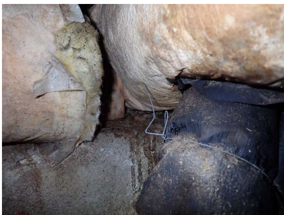
Kuva 3.3 Mikrobivaurioita materiaalien pinnalla, puuosissa taustalla kosteusjälkiä
