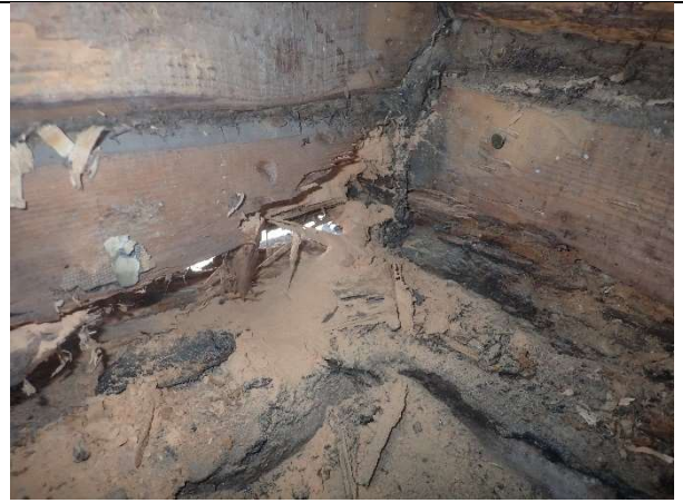
Kuva 3.58. Hirsirakenne läpilahoa nurkasta
