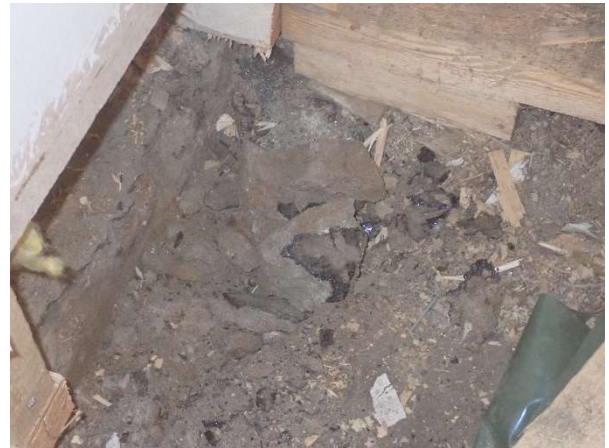
Kuva 3.69. pohjalaatta rikki ko.kohdalla, maaperästä ilmayhteys rakenteeseen
