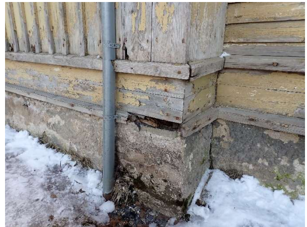
Kuva 3.6. Pohjoispuolelta ulkonurkkaa, lahovaurioita pinnassa, pintoja avattiin
