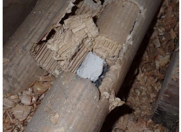
Kuva 5.2 RA #2, putkieristeissä mahdollisesti asbestia
