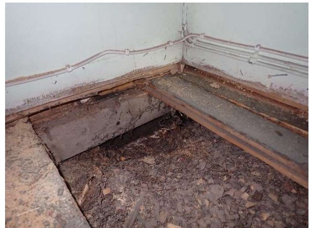
Kuva 3.56. nurkassa valonkajastusta havaittavissa, hirsirakent läpilaho
