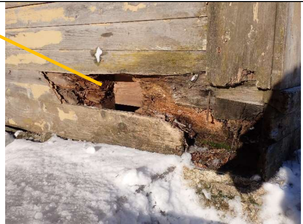
Kuva 3.24. Kuistin rakenteissa jo lahovaurioita
